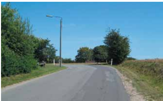
Gående er udsatte langs den sydvestlige del af Fløjbjergvej da markeringen er mangelfuld.
